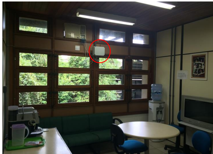
Figura.5: Sistema Inteligente instalado no ar condicionado
